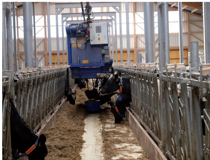
Fot. 7. Wózek paszowy podwieszany na szynie nad stołem paszowym o szerokości około 2 m w oborze krów mlecznych (fot. A. Kaczor)
