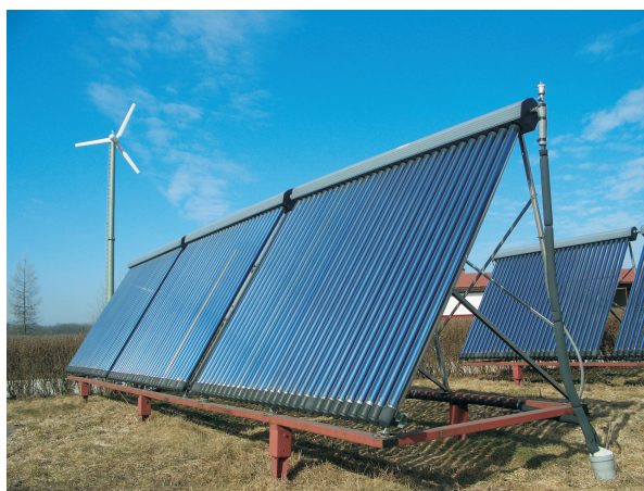
Kolektory słoneczne i generator wiatrowy – Żerniki Wielkie
