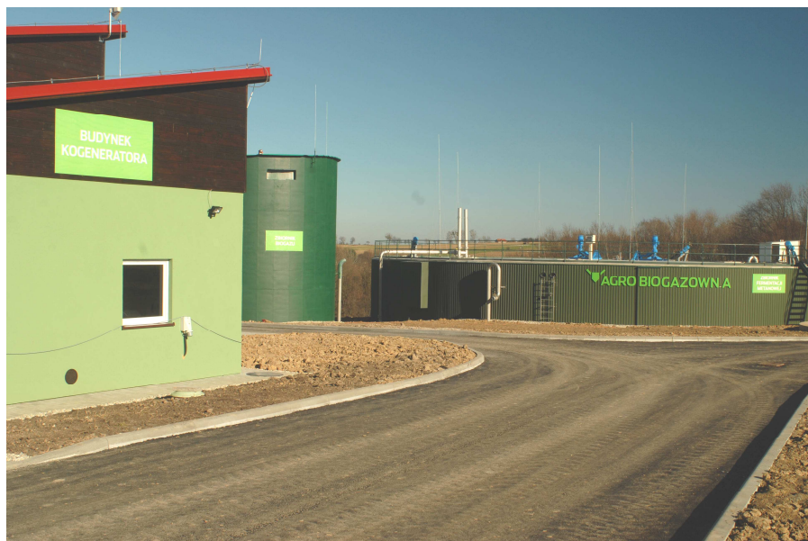
Agrobiogazownia (kogenerator, zbiornik biogazu, reaktor fermentacyjny) w ZD Grodziec Śląski (fot. archiwum) Agricultural biogas plant (co-generator, biogas reservoir, digester) at the Experimental Station Grodziec Śląski (photo archive)
