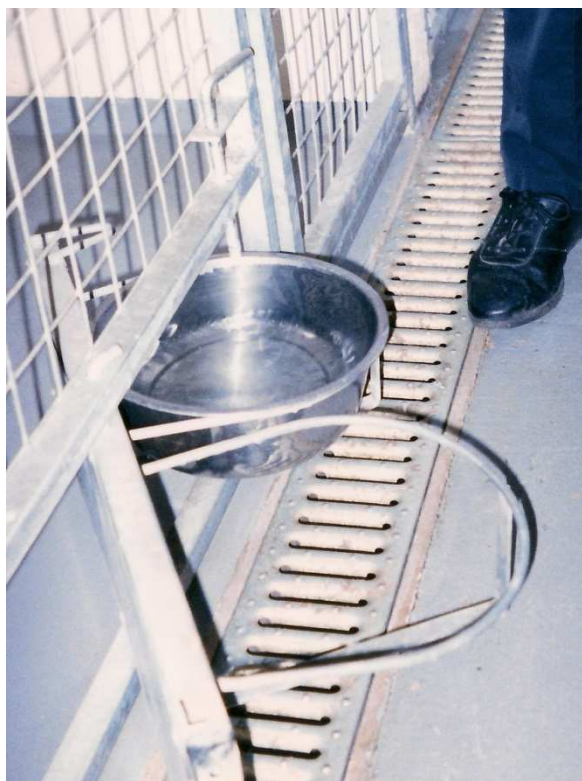
Fot. 5. Wbudowany w ściankę kratową obrotowy stojak na miski i odpływ kanalizacji w korytarzu biegnący wzdłuż boksów
