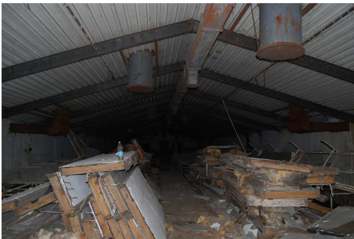
Fot. 1. Opuszczony budynek po dawnej fermie króliczej (stan przed remontem) Fig. 1. Abandoned building of a rabbit farm (before renovation)
