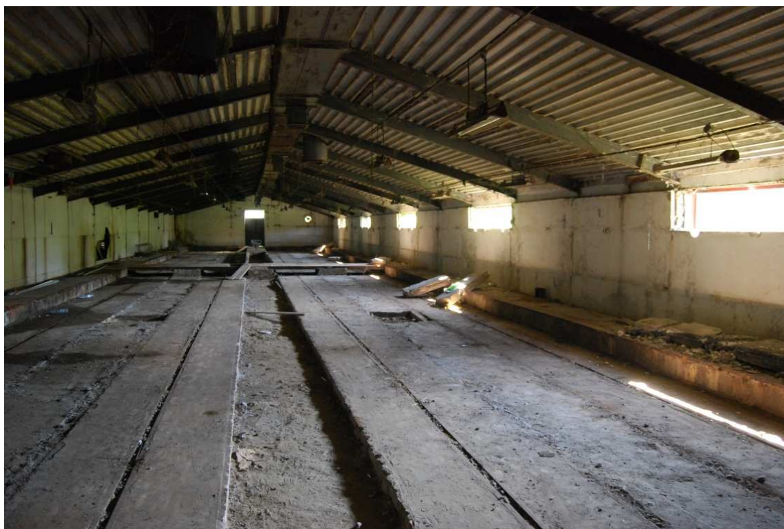
Fot. 2. Budynek przeznaczony na przyszłą oborę w trakcie prac remontowych Fig. 2. Building of a future barn during renovation
