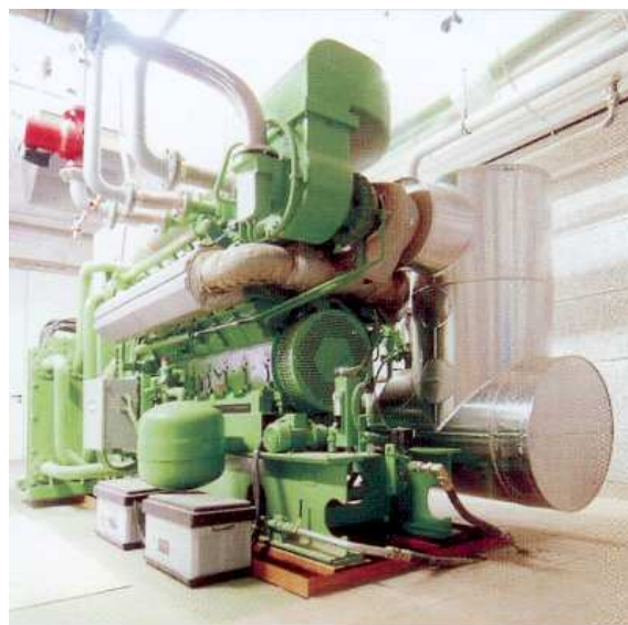
Zbiornik kogeneracyjny (Farmtec) Cogeneration unit
